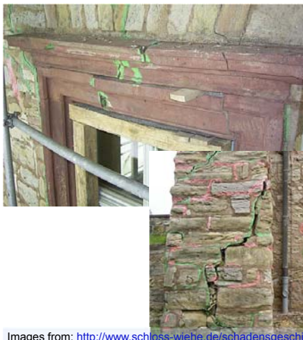
Damage after portland cement injection in Schloss Wiehe (D)
